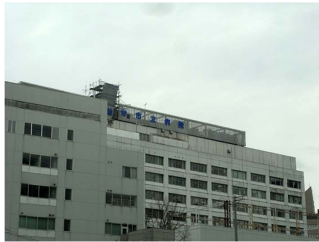
(写真20) 仙台市立病院 破損した煙突
